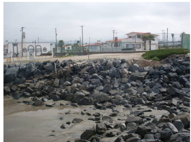
Figura 6. Enrocamiento construido región norte de las costas de la Bahía de Todos Santos visiblemente dañado por acción del oleaje.
