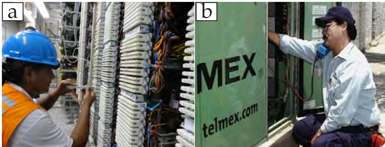
Figura 1. Ejemplos de instalaciones físicas de centrales telefónicas a): Fuente: Switchtel tecnologías y telecomunicaciones. b) Fuente: Cursos en línea. Como diagnosticar y reparar fallas en redes telefónicas y conmutadores.
